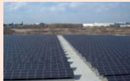
太陽光発電設備
