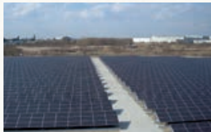
太陽光発電設備
