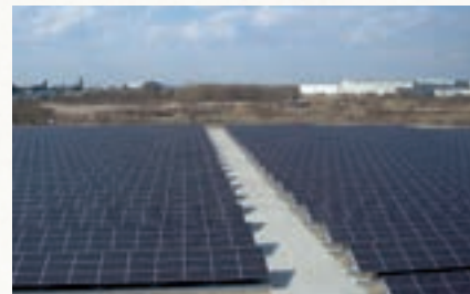
太陽光発電設備
