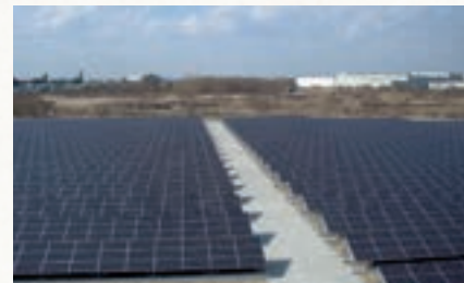
太陽光発電設備
